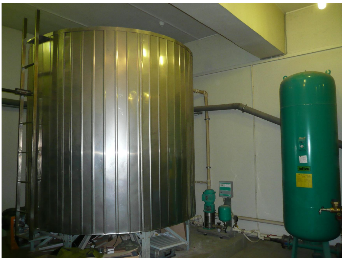
Бак накопитель и 1-я ступень системы очистки воды
