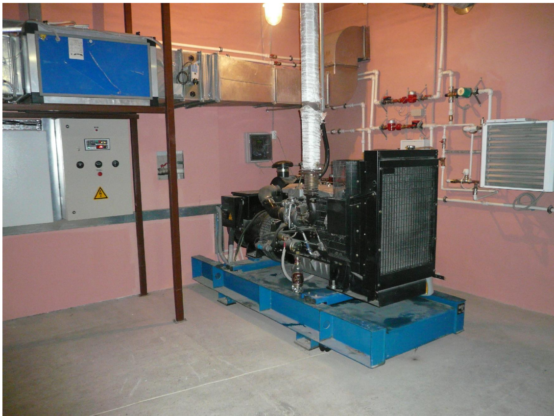
Дизель-генераторная установка в гараже под жилым домом
