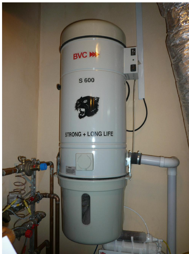
Встроенный пылесос, расположенный в техническом помещении
